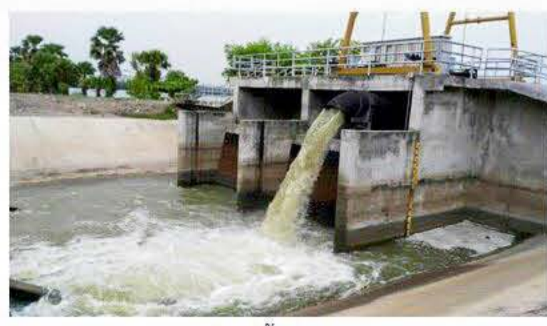
สถานีสูบน้ำด้านคลองหก
