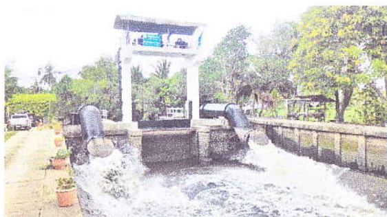
สถานีสูบน้ำ ปตร.ท่าเสา
